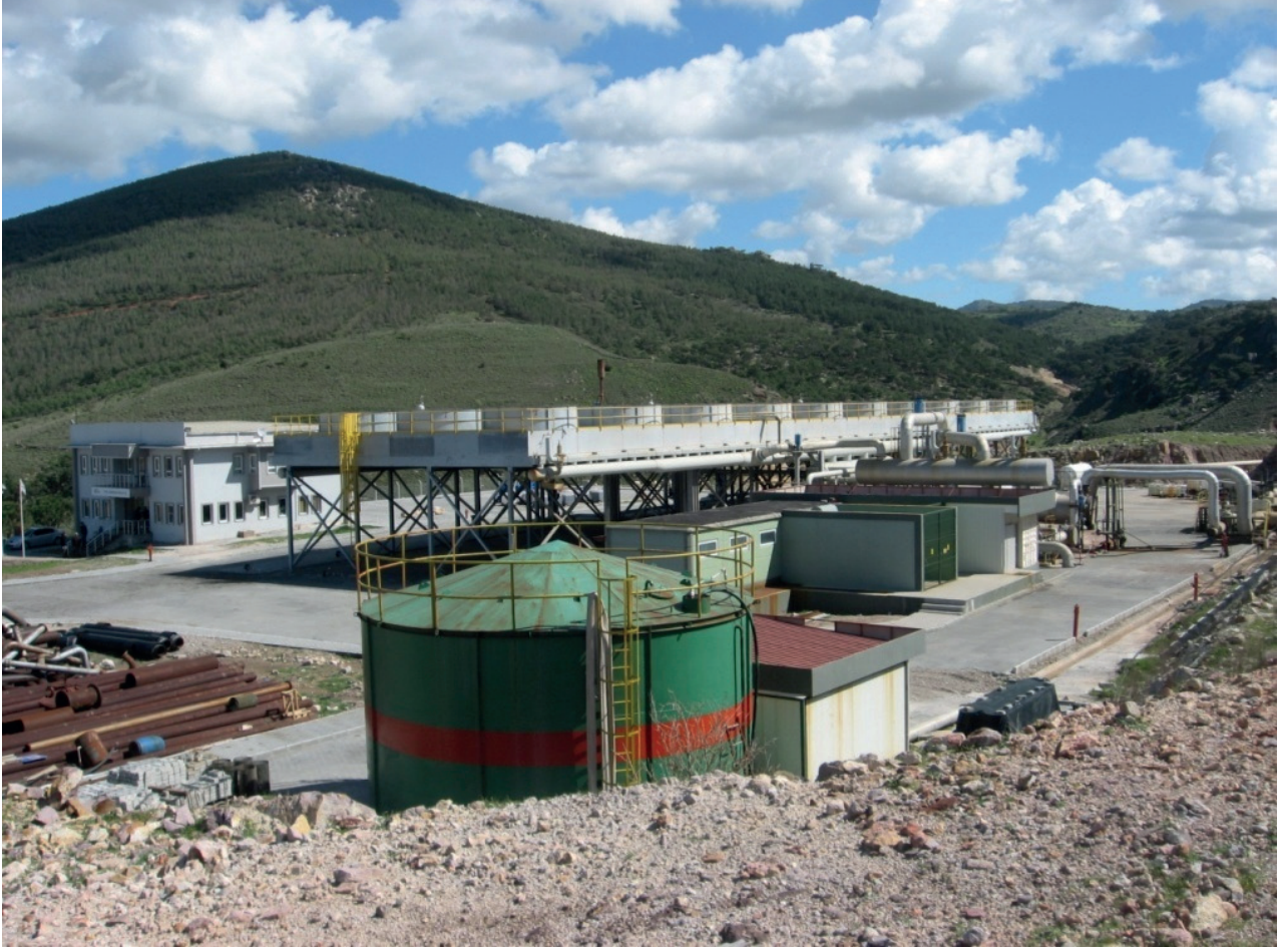
Şekil 6.5. Tuzla Jeotermal Elektrik Santrali
